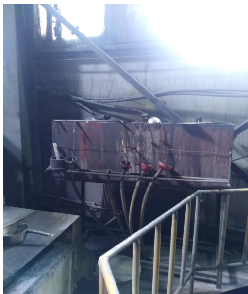
调药罐操作平台
