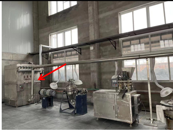
氮化硼特种工业陶瓷材料 车间废气处理设施
