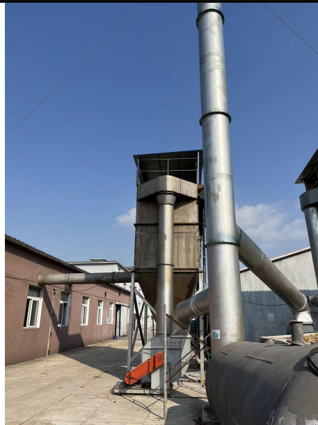
无定型硼粉车间、二硼化钛（锆）车间排气筒 DA001
