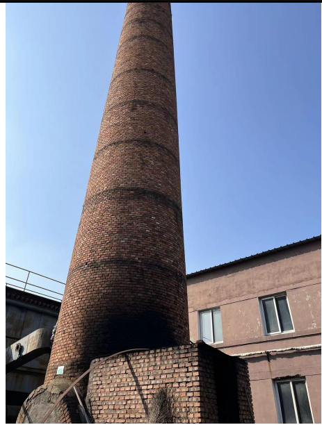
锅炉（4t 生物质锅炉）排气筒
