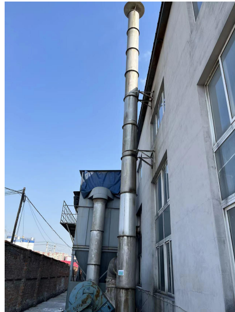
六方氮化硼反应车间和氮 化硼特种工业陶瓷材料车 间排气筒 DA003 总排口
