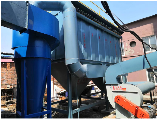
锅炉（4t 生物质锅炉）废气处理设施
