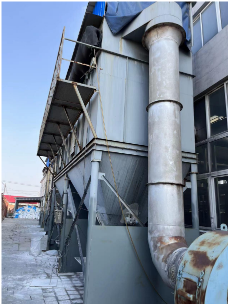
六方氮化硼反应车间废气处理 设施
