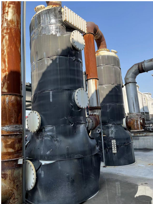
六方氮化硼混料车间废气处理设施
