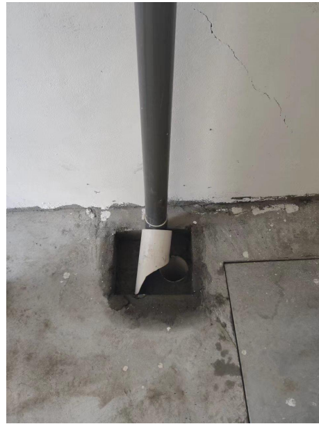
生活污水处理站排口
